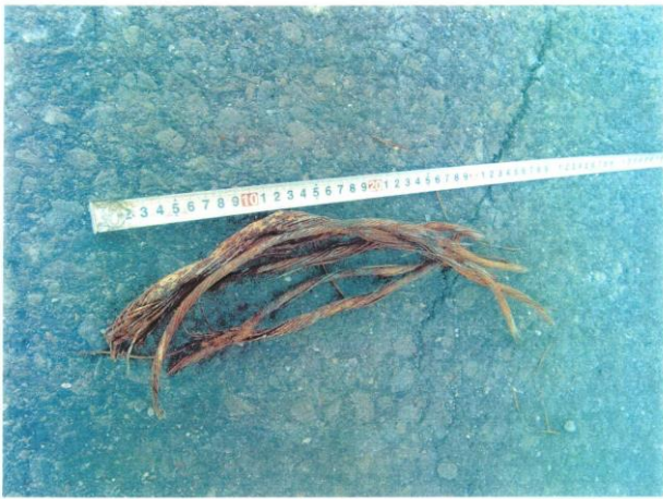
推進中に排出したワイヤー片
