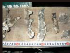
東京都千代田区大手町 人孔壁の鉄筋コンクリート壁厚1m H-150 5本 ライナー6段
