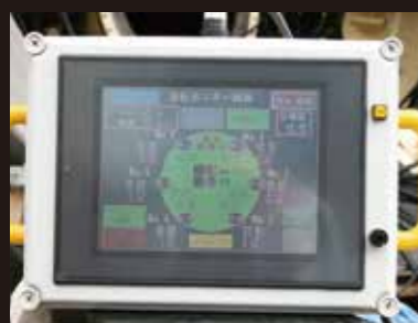
特殊伸縮装置コントロールパネル
